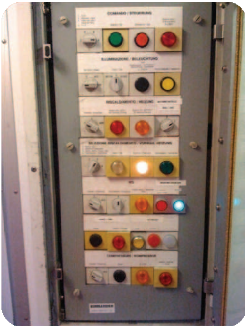
Quadro di comando da dove si effettua il test del freno di emergenza.
