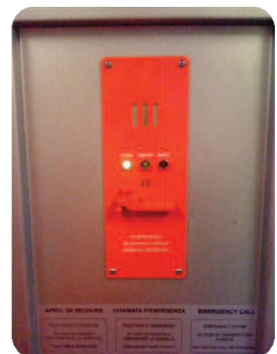
Citofono di una carrozza dell'autostrada viaggiante
